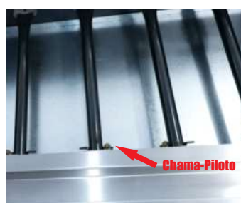
Vista da chama piloto e dos queimadores estaltados
