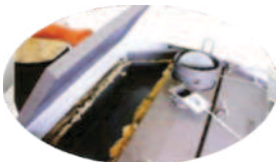
Compartimento de limpeza: acima, vista em detalhe do compartimento de limpeza da fuligem, localizado na parte superior do forno. Sua função é facilitar a limpeza das canaletas e maximizar a saída de fumaça.
